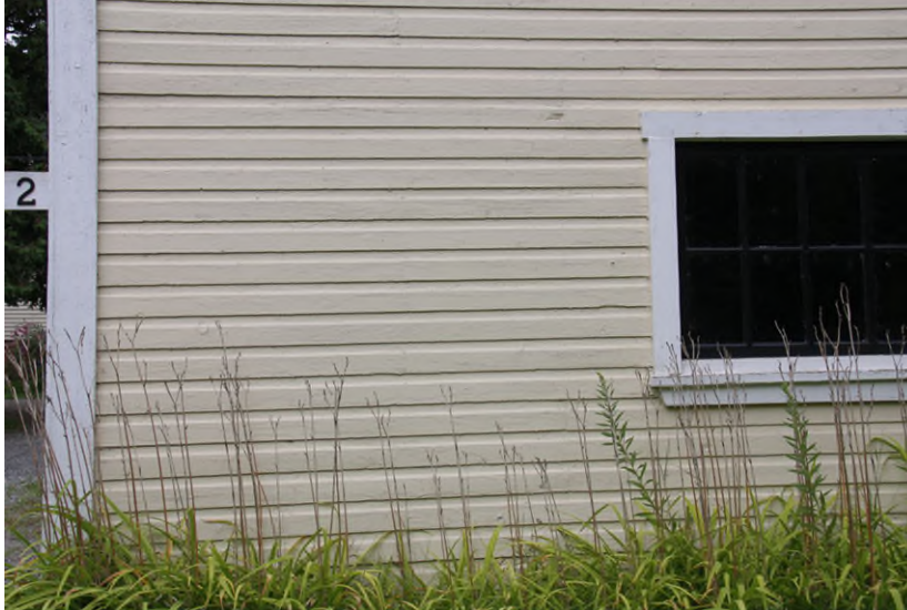
Exemple de revêtement de planche à feuillure. Adam Noyes House, une ancienne maison de pionnier devenue bâtiment accessoire, datant des environs de 1824, au 2, chemin McGowan. IMG _8657.jpg
