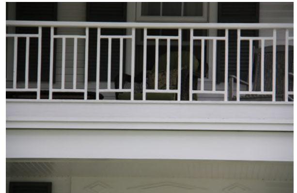
Rare garde-corps Stick Style en ferronnerie ancienne au 4651, chemin de Georgeville. IMG _8620.jpg
