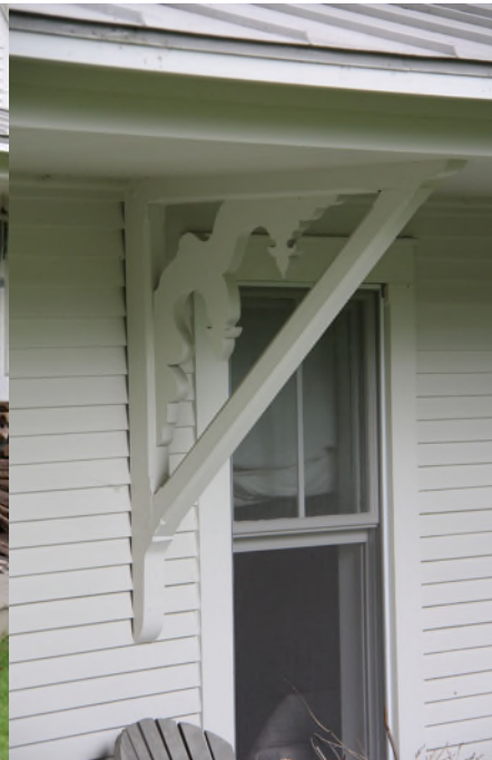
Détail d'une des équerres du 43, chemin de Magoon Point. IMG_8701.jpg
