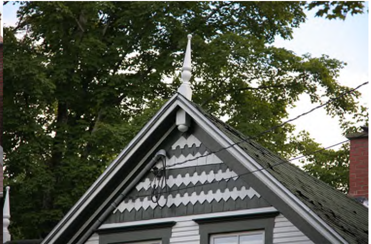
L'un des faîteaux en bois plantés au sommet des pignons du 44, chemin de Magoon Point. IMG_8730.jpg
